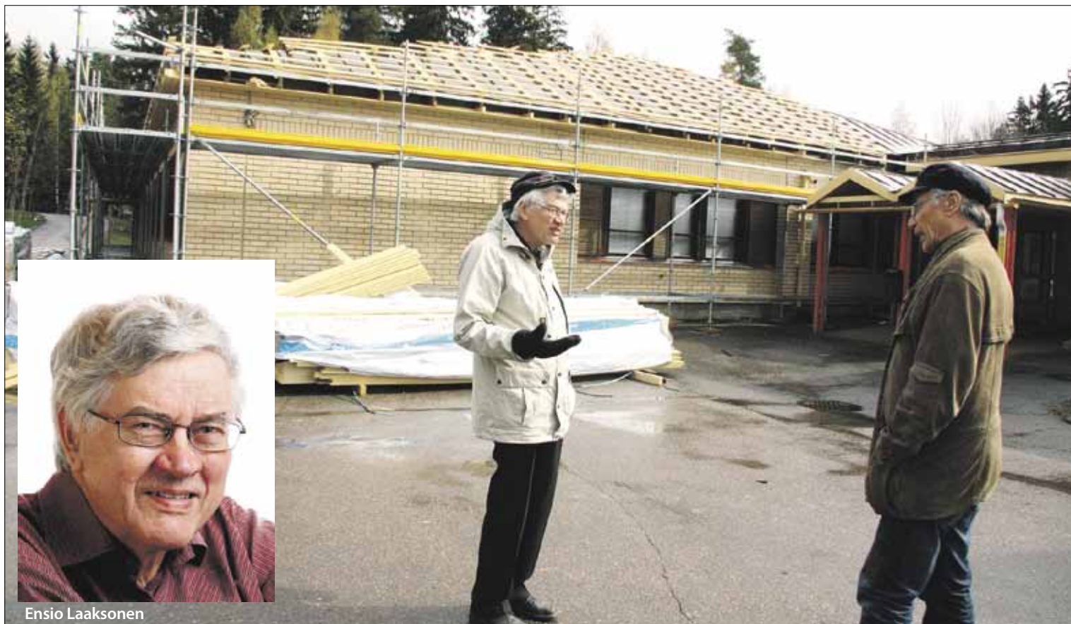
Asiantuntijamme Ensio Laaksonen selvittää toimittajalle homeen mysteeriä homeremontissa olevan Vantaan Havukosken koulun pihalla.
